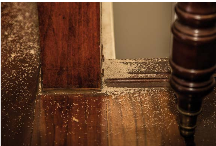
Εικόνα προσβολής ξύλινου στοιχείου σε εσωτερικό χώρο.
