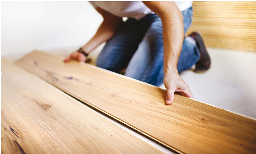
Βιομηχανοποιημένο δάπεδο από κόκκινο κέδρο Αμερικής (Western red cedar). Τα δάπεδα πολυστρωματικού τύπου λαμινέιτ αντικαθιστούν σε σημαντικό βαθμό πλέον το μασίφ ξύλο.
