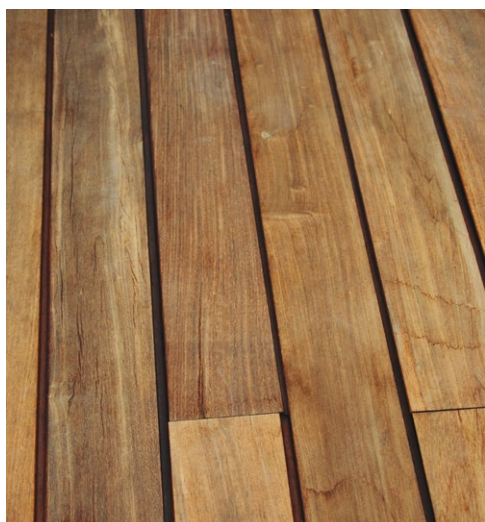
Δάπεδο τύπου deck, από ξυλεία Iπέ, δίπλα σε πισίνα στην Αττική. Από τις έντονες εναλλαγές θερμοκρασιών και την έντονη ηλιακή ακτινοβολία παρατηρήθηκαν κάποιες μικρές "μετακινήσεις" των στοιχείων μέσα σε ένα έτος. Η τακτική διαβροχή των στοιχείων στην άνω πλευρά θα περιορίσει ή θα αποτρέψει αυτό το φαινόμενο.
