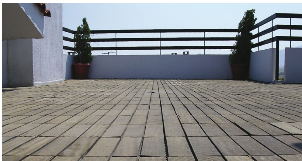
Δάπεδο από ξυλεία kempas, που διαστρώθηκε με deck tiles σε βεράντα στην Αττική. Η ανομοιογένεια των συνθηκών μεταξύ άνω και κάτω επιφάνειας στο ζηροθερμικό κλίμα της Αττικής επέφερε παραμορφώσεις και ραγαδώσεις στην άνω πλευρά, μέσα σε 2 έτη.
