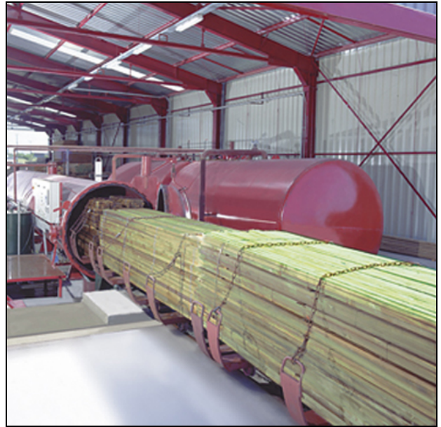
Θάλαμος εμποτισμού ξυλείας υπό υψηλή πίεση
