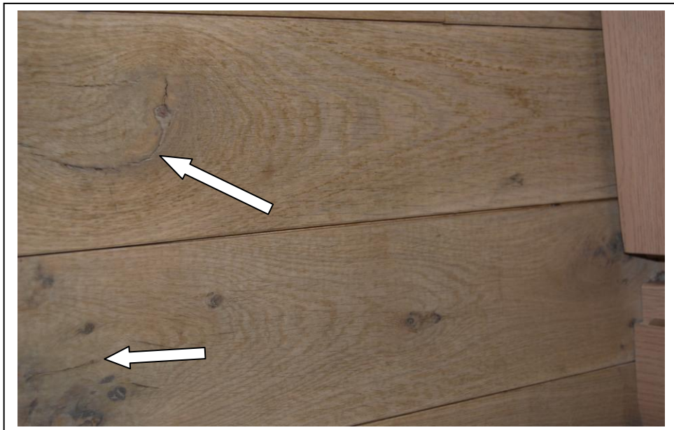
Φωτ.3. Ύπαρξη ραγάδων.
