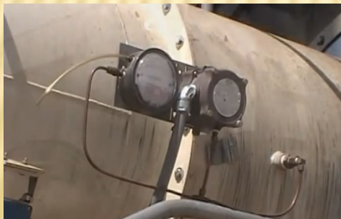
ΑΝΙΧΝΕΥΤΗΣ ΦΩΤΙΑΣ & ΠΥΡΟΣΒΕΣΗ (SPARK DETECTOR & FIRE EXTINGUISHER)
